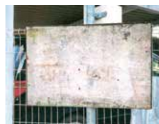
掲示板修繕前
